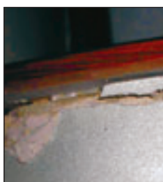
poškození staveb vlhkostí
