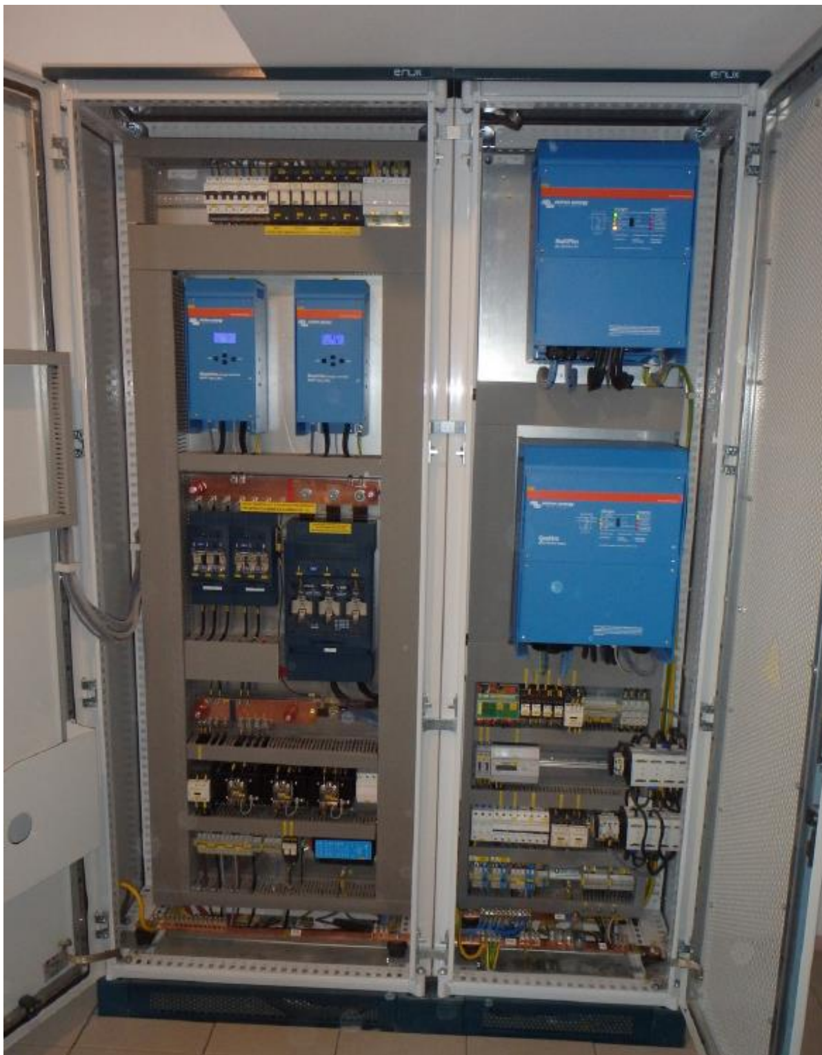
Veškerá vnitřní technologie je umístěna v kompaktním elektrorozvaděči.
