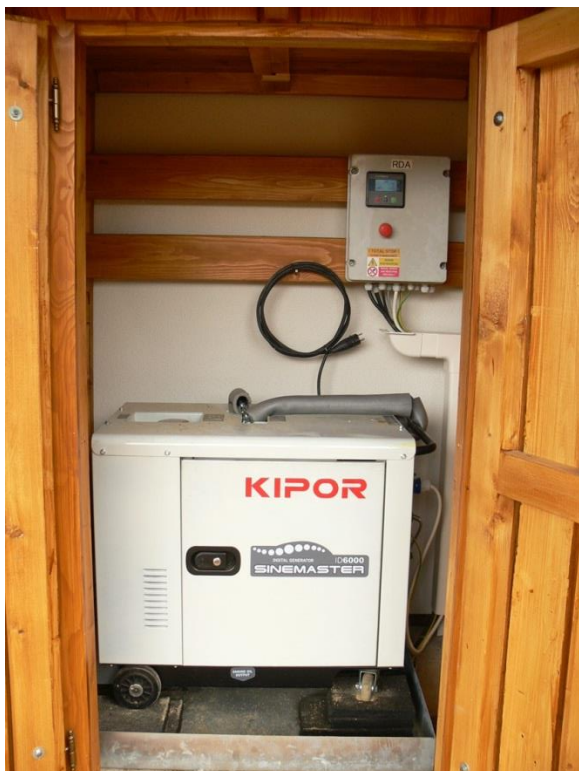
Hlavní generátor Kipor Sinemaster IG 6000 včetně automatického startu (elektrorozvaděč) a možnosti připojení záložního generátoru Kipor Sinemaster ID 2600 (černý kabel).
